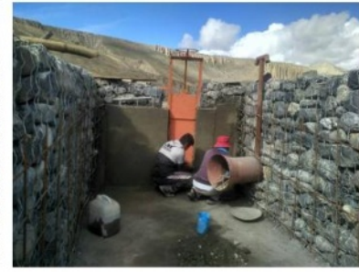
le bassin de décantation
