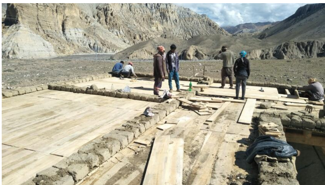
Préparation du plafond qui sera recouvert d'un film hydrofuge avant d'être recouvert de la terre battue qui fera le sol de la terrasse.
