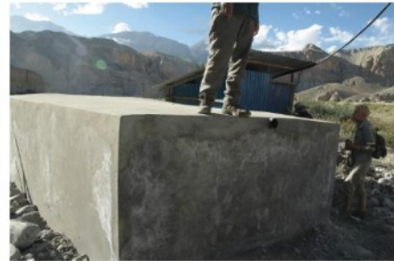
le réservoir de distribution au village
